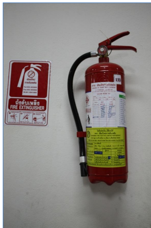
ถังดับเพลิง
