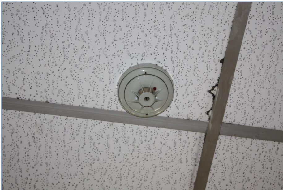
ที่พ่นน้ำอัตโนมัติเมื่อเกิดเพลิงไหม้
