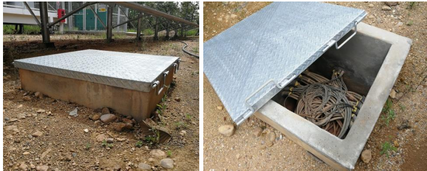
รูปภาพ 56 บ่อพักสายไฟ
