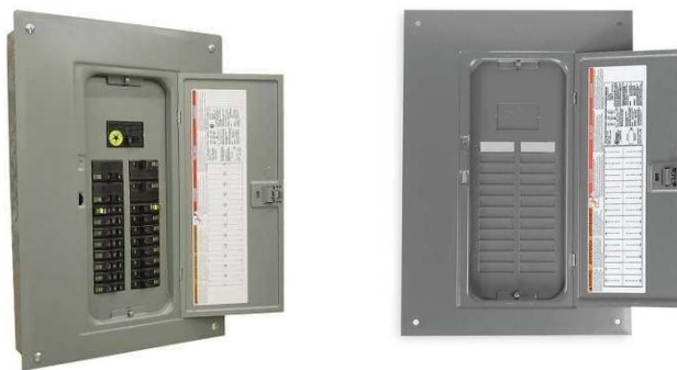
รูปภาพ 36 ตู้ Load Center
