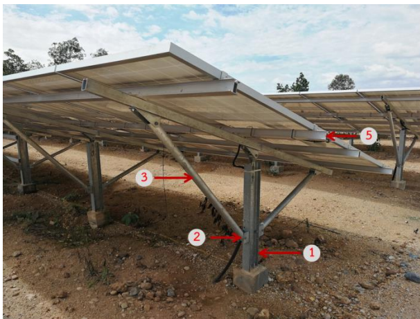
รูปภาพ 31 โครงสร้างรองรับแผงเซลล์แสงอาทิตย์แบบติดตั้งบนพื้นดิน
