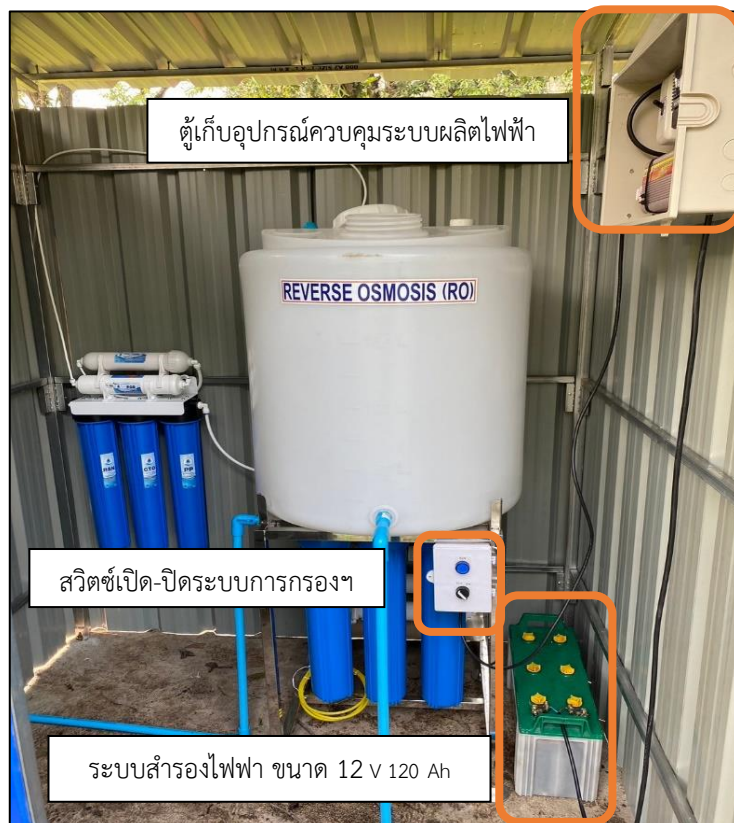
ภาพที่ 11 แสดงอุปกรณ์ควบคุมระบบผลิตไฟฟ้าจากพลังงานแสงอาทิตย์สำหรับระบบกรองน้ำ
