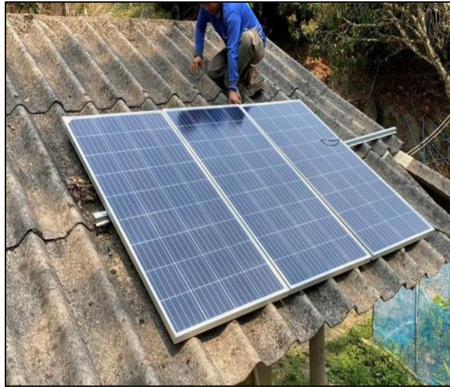
ภาพที่ 10 การติดตั้งระบบผลิตไฟฟ้าจากเซลล์แสงอาทิตย์ ขนาด 540 w
