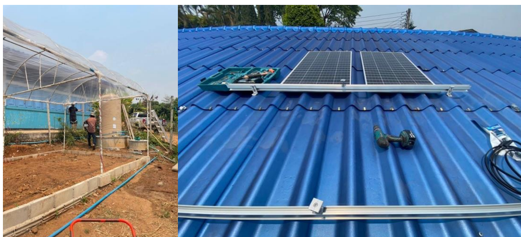
ภาพที่ 2 ติดตั้งชุดสาธิตระบบเทคโนโลยีปั้มนสูบน้ำพลังงานแสงอาทิตย์อย่างง่าย บริเวณสวนเกษตรอินทรีย์ โรงเรียนบ้านลาน หมู่ที่ 5 ตำบลม่อนปิ่น อำเภอฝาง จังหวัดเชียงใหม่
